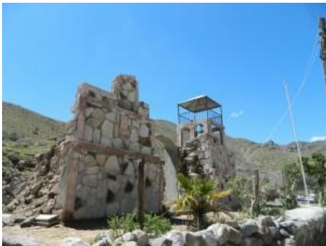
Iglesia gravemente dañada por terremoto
